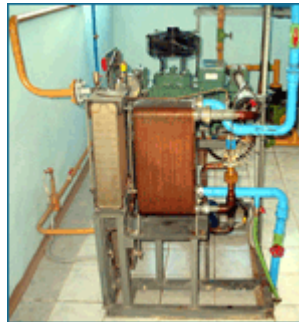
Тепловой насос, работающий на Малоярославецком водоканале. (Тепловая мощность 150 кВт).
