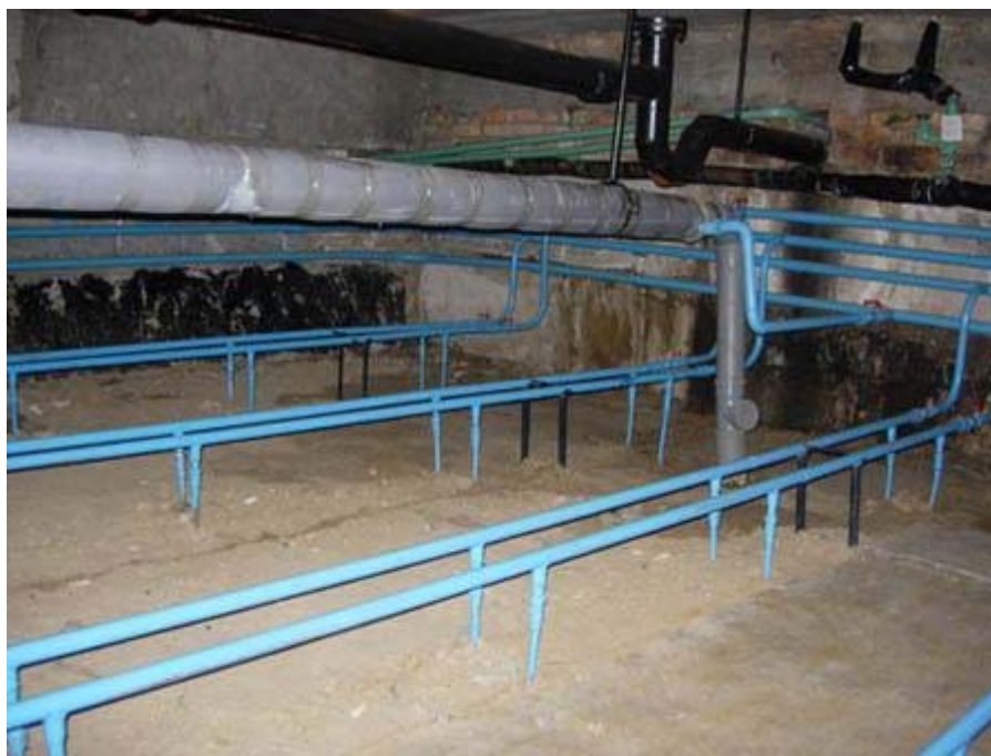
Рис.3: Установленный в подвале жилого дома сточно-гликолевый теплоприемник. Петли для теплоприемника выполнены из трубы PEX-а системы GOLAN-AQUA-PEX.
